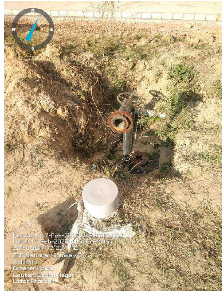
Sec-5 Existing Tubewell in DH Sealed
